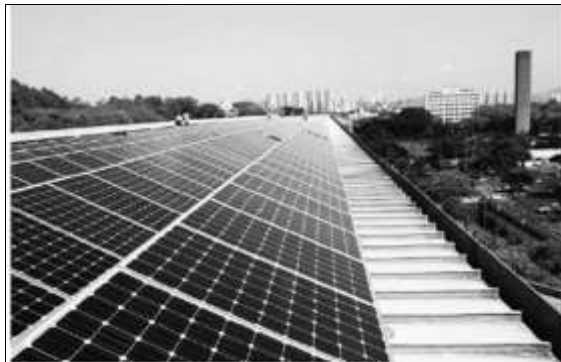
II – Paineis fotovoltaicos
